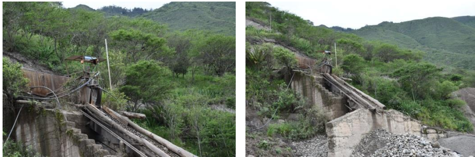
Planta de lavado hidráulico
