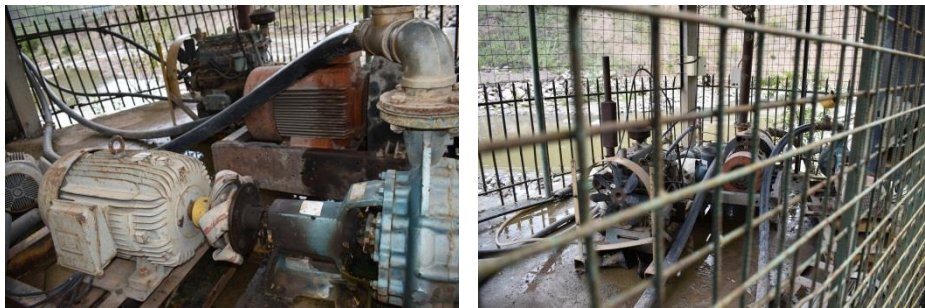
Vista general de las bombas de succión
